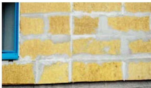
Nevhodné „vyplňování“ spár lepidlem (obr. 21)
