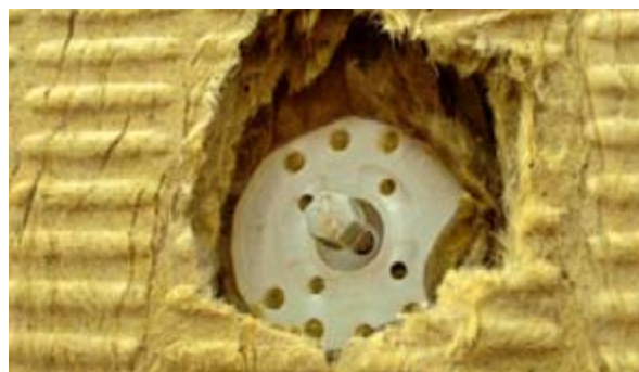
Ukázka špatně zapuštěné hmoždinky (obr. 31)
