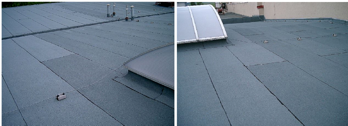
Obr. B1 Pohled na stejnou partii střechy z různých směrů – odstín asfaltového pásu se mění podle směru pohledu. Na obrázku vlevo jsou pásy u světlíku tmavší, na obrázku vpravo je stejná oblast při pohledu z jiného úhlu světlejší.
